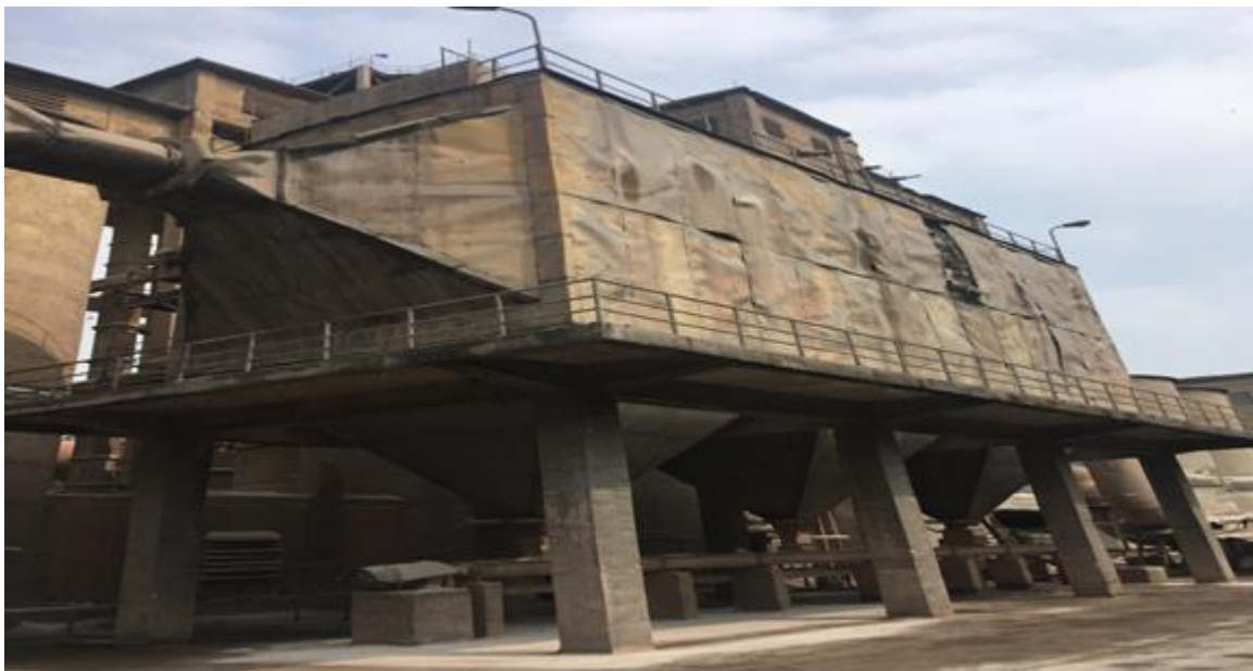
Hình 3.4. Hệ thống lọc bụi công suất lớn PPCS64-6 tại nhà máy
